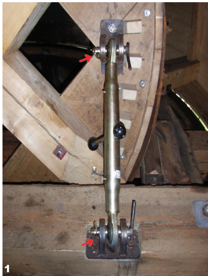
1 Stormsikringen består af topstænger (én i hver side) fæstnet til bjælkerne med et vippebeslag (nederste pil). Øverst ender stangen i et øje, som passer ind i et beslag, som det fastholdes i med en rigel, der igen låses med en split (øverste pil).
